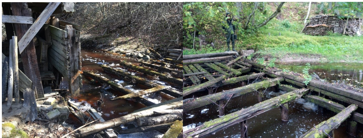
Foto 30. Võsu jõe Mere pais, vaade paisust allavoolu (vasakul; 20.04.2021) ja vaade paisule (21.09.2022). Madalveega imbub vesi läbi paisuvare konstruktsioonide.
