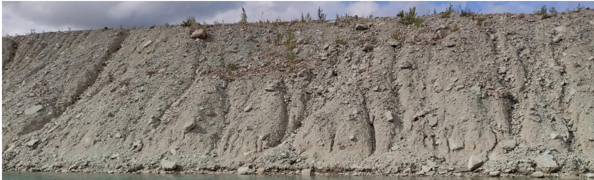
Foto 1. Aidu lõunapoolse lõputranšee erosiooninähetega taimestumata nõlv (august 2020).
