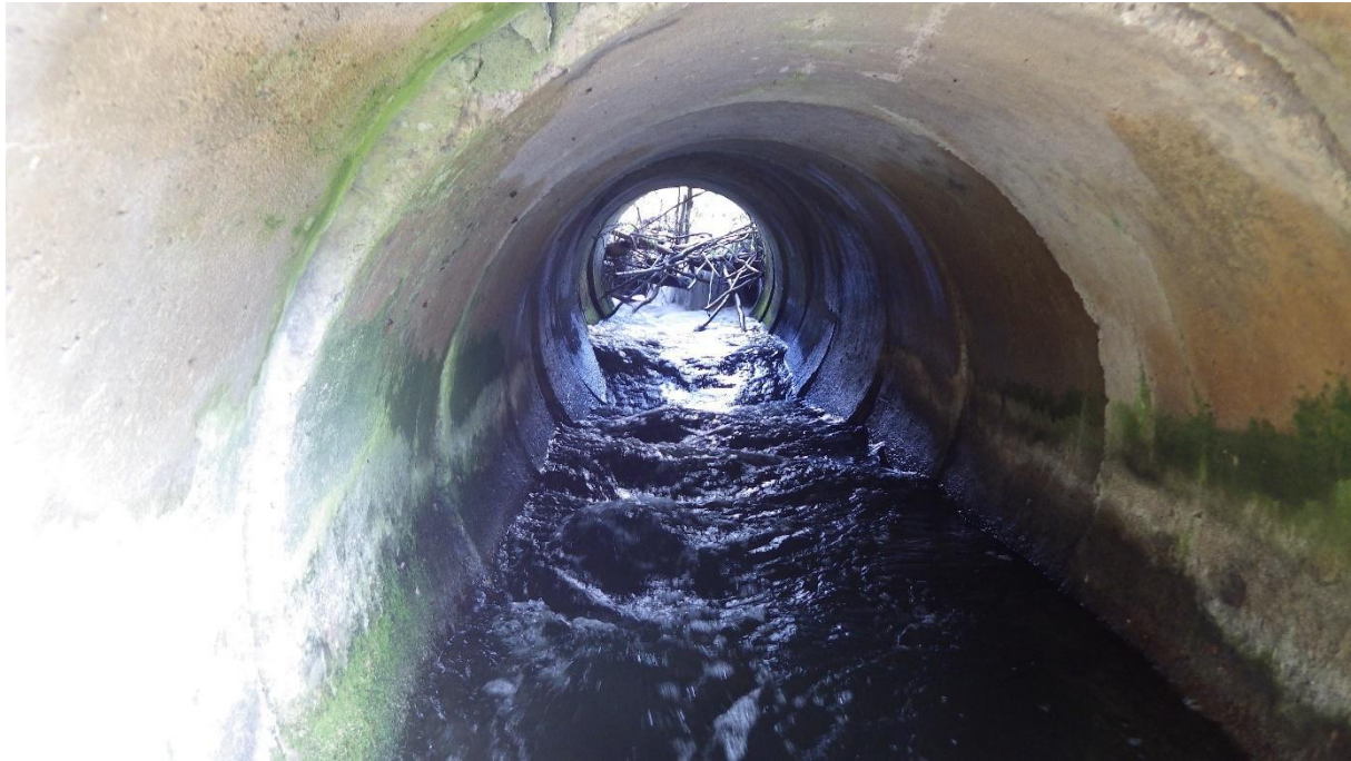
Foto 12.05.2021. Ojaküla truubi sissevool koprarisu ummistusega.
